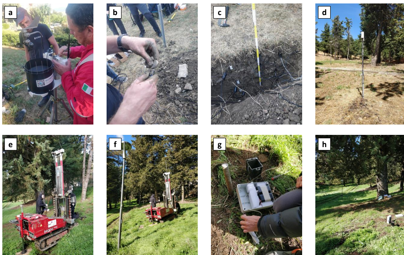
Figura 8: Immagini rappresentative delle operazioni d'installazione dei sensori nei punti RG, M1, M2, M3 (a-d) e P1, P2, P3, P4 (e-h) nel sito di monitoraggio pilota #2.
