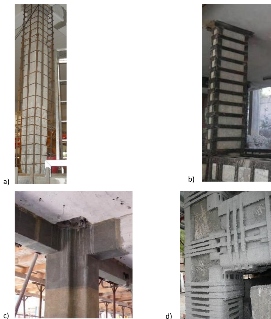
Figura 12. Incamiciatura in c.a. (a), in acciaio (b). Rinforzo dei nodi con FRP (c) e con il sistema DIS-CAM (d).
